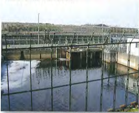
集水池（ポンプ井）
