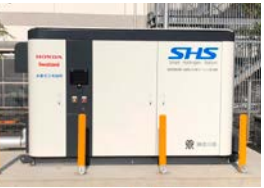
設置された再エネ水素ステーション
